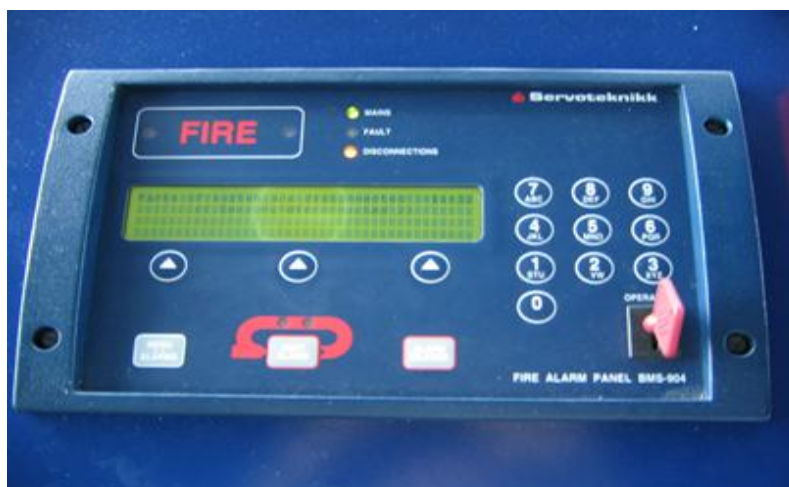
Slika 11 - Kontrolna ploča na komandnom mostu (Fire Alarm panel)
