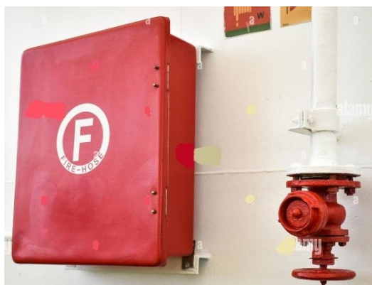
Slika 32 – Hidrant s ormarićem
