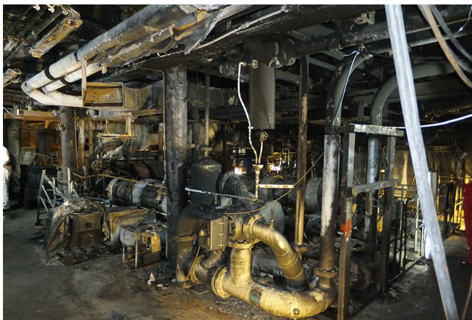
Slika 34 – Požar u strojarnici broda
