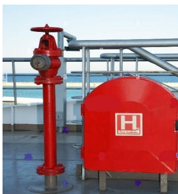
Slika 21 – Hidrant s ormarićem na brodu
