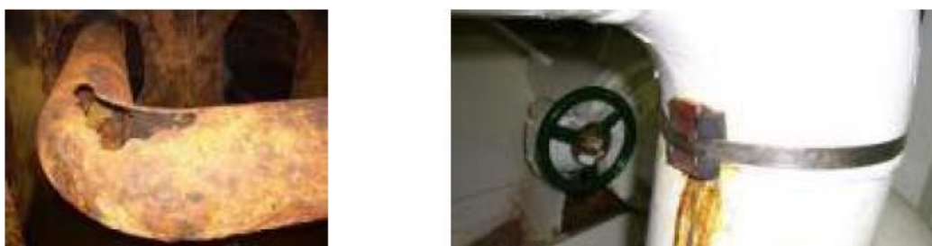
Slika 81. Oštećenja cijevi: a) cijev koju treba trajno sanirati; b) privremeni popravak
