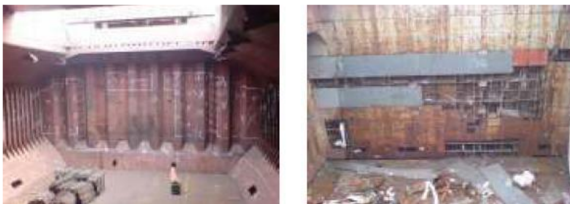
Slika 76. Korodirana nepropusna poprečna/uzdužna pregrada skladišta spremna za zamjenu
